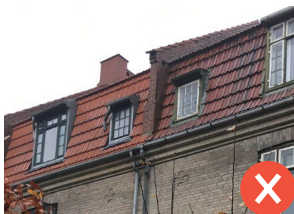
Fotos af tagkviste med gode og dårlige afvandingsløsninger
